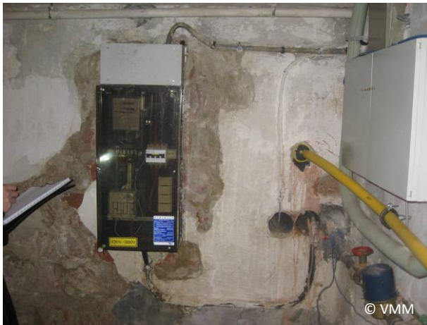
Elektrische teller: onderaan de ingang voor de kabel vanuit het openbaar net, bovenaan de uitgaande kabel
