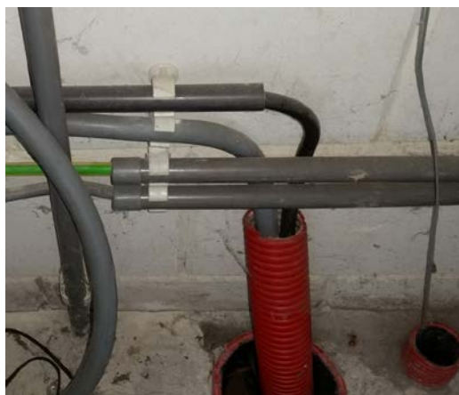
Kabels in trekbuizen
