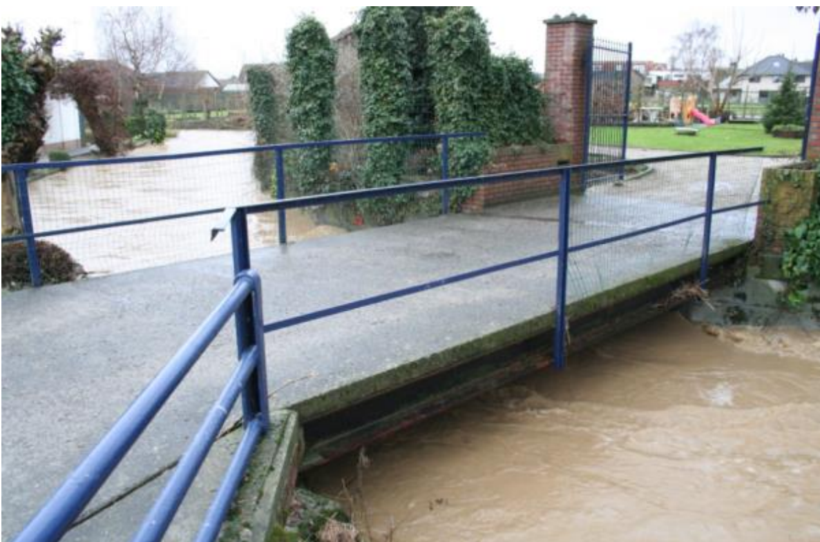
Figuur 14: private brug in Wolfabriekstraat naar huisnr.26 (gezien van afwaartse kant)
