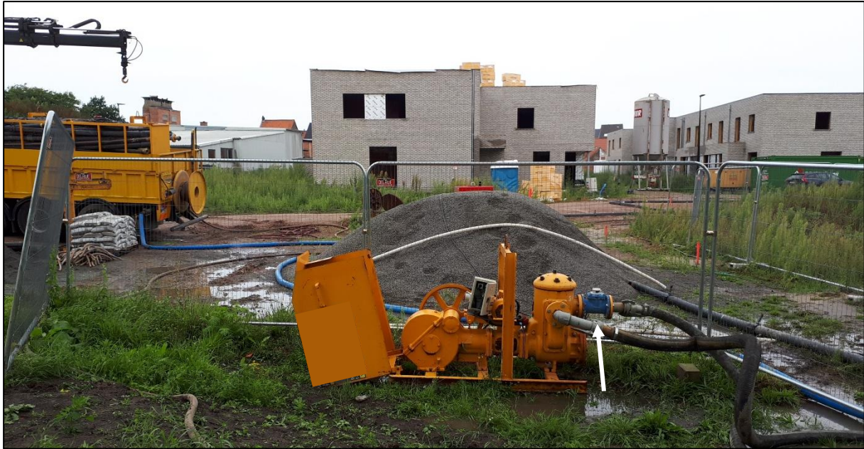
Figuur 57: fout opgestelde debietmeter (witte pijl). Er zijn geen aangepaste leidingstukken voor en na de debietmeter, er is geen opwaartse leiding voorbij de debietmeter, er werd geen mogelijkheid tot ontluchting voorzien en er is geen controle op volle leiding
