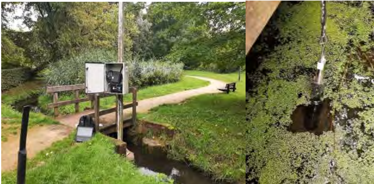
Figuur 5: Installatie van Nico+ nitraatsonde in de bovenloop van de IJse in Hoeilaart.
